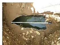
▲管の破損箇所
